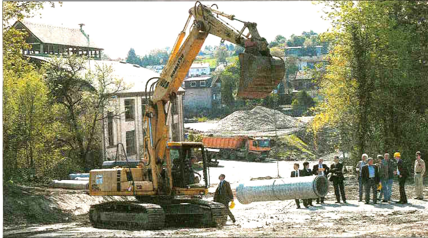
Schweres Gerät wurde am Dienstagmorgen für den Spatenstich am Ober-Ramstädter Miag-Gelände aufgefahren.
